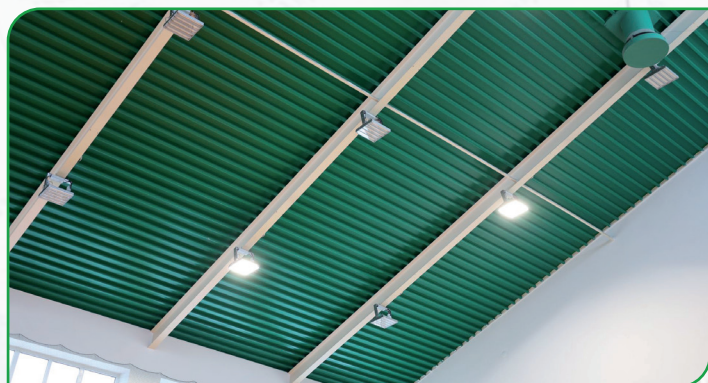
Fot. Nowe energooszczędne lampy LED u sufitu sali gimnastycznej
