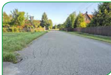
Uszczerbki i zniszczenia na drodze w Pasiekach
